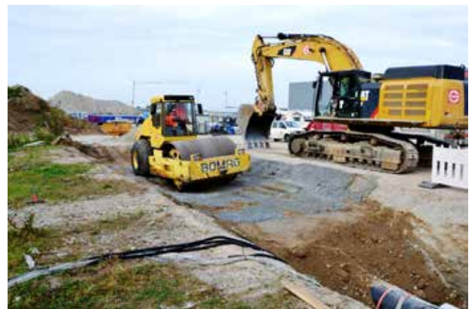
Bild 5: Unsachgemäße Verdichtung in Minderdeckung als Überlastungsversuch
