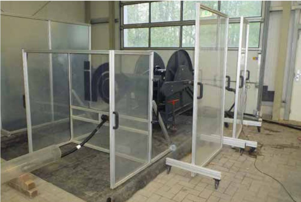
Schlauchhaspel im Einsatz bei Verfahren 2 (Praxisprüfung)
