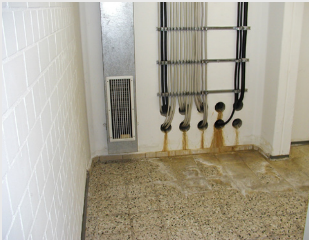
Bild 2: Beispiel undichte Kabeldurchführung
