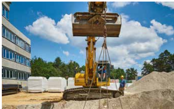
Sedimentationsanlage zur Regenwasserbehandlung
