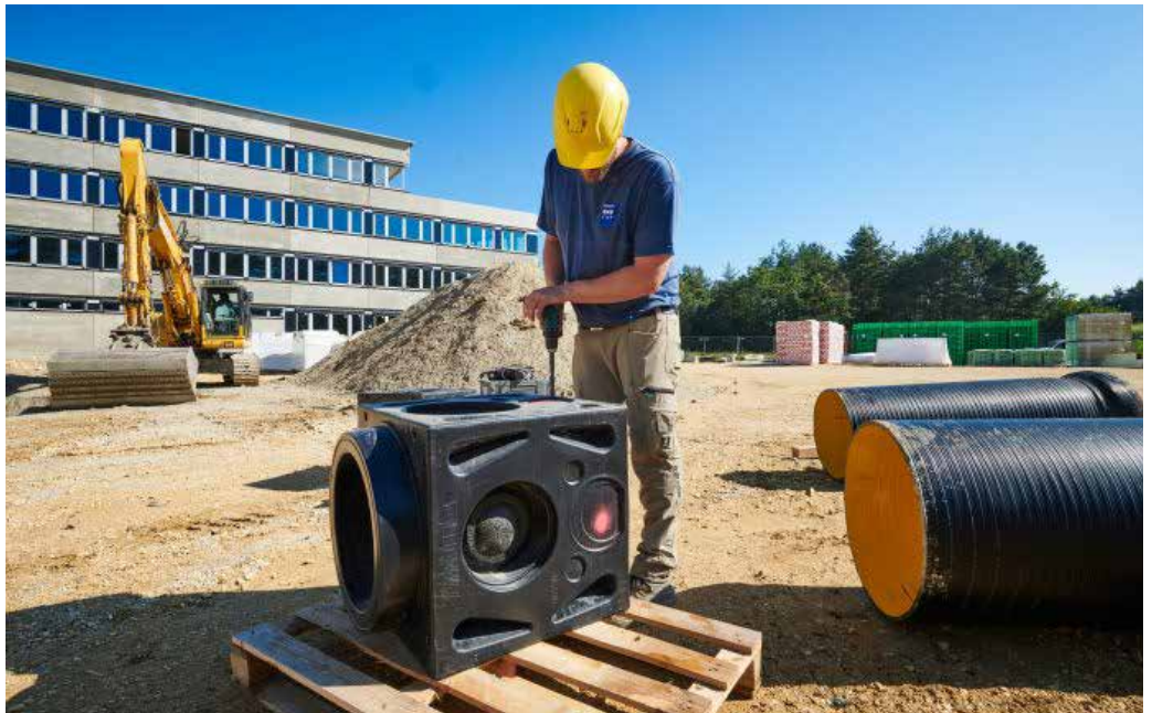
Kontrollschacht zur Regenwasserversickerung
