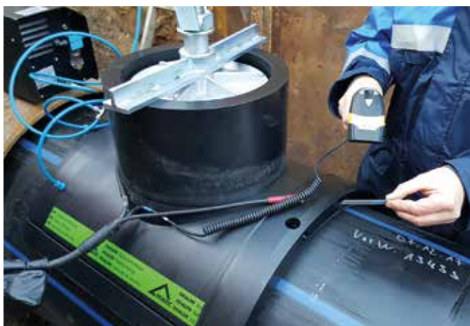
Ein Wasserversorgungsnetz ist niemals fertig. Instandhaltungs- und Umbaumaßnahmen gehören zum Betriebsalltag. Neue Verfahren und Techniken helfen dabei, Betriebs- oder Instandhaltungskosten zu reduzieren. Foto: Friatec AG
