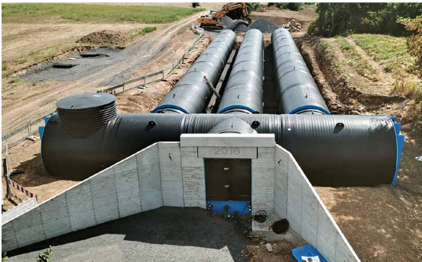
Zu einer nachhaltigen und sicheren Wasserversorgung gehören Trinkwasserspeicher, die Verbrauchsspitzen abfedern und einen gleichbleibenden Druck im Netz sicherstellen. Foto: Frank GmbH
