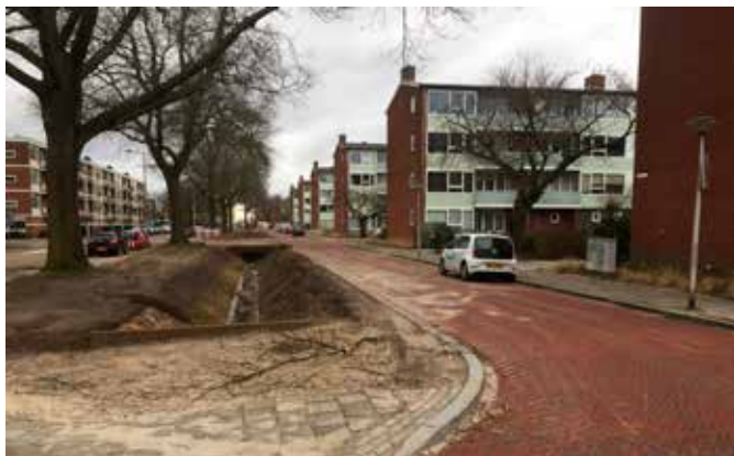
Pilot-Realisierung in Enschede – Errichtung von Gräben (offene Wasserwege) zur Vermeidung von Überschwemmungen infolge von Starkregenereignissen
