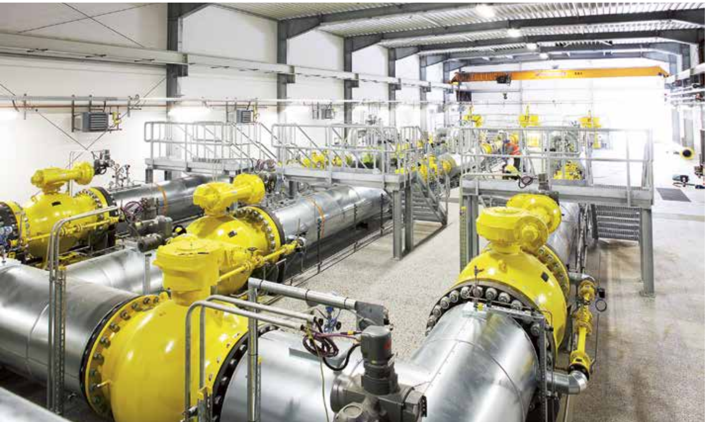
Erdgasübernahmestation Waltersdorf vor den Toren Berlins
