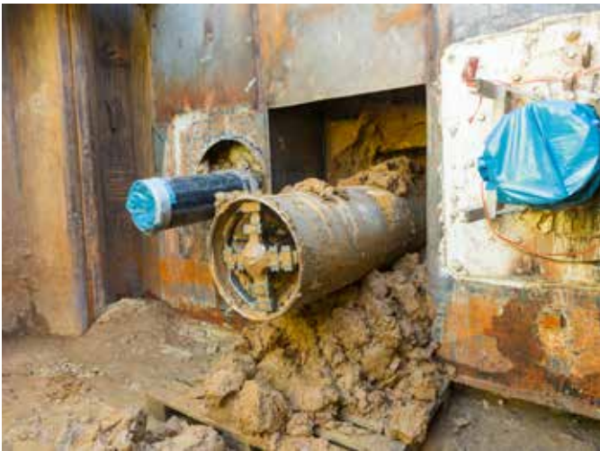
E-Power Pipe® Premiere: neue Technologie für Erdkabelverlegung (Borken, DE). Foto: Herrenknecht AG
