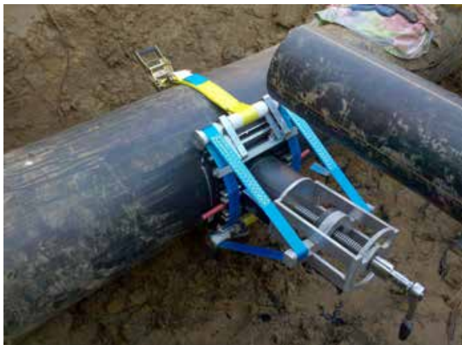
Einbindung Hauptleitung unter 4 bar Betriebsdruck (Gas). Anschlüsse an PE-Großrohr unter Betriebsdruck ohne Trennen der Leitung möglich. Foto: FRIATEC AG
