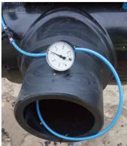
Bild 4: Überwachung der Absperrung mittels Manometer
