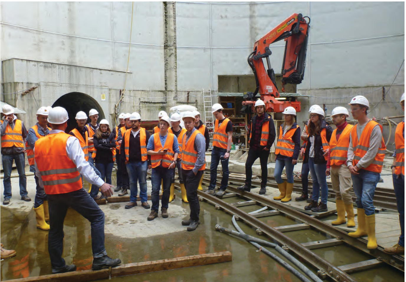
Exkursionsteilnehmer erhalten fachliche Informationen auf der Sohle der Baugrube der Firma PORR
