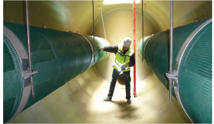
Gründliche mechanische Vorreinigung von Mischwasserströmen: Das Kernelement der AmiScreen-Technologie sind die im Speicherrohr installierten Grobstoff-Rückhalteelemente, deren Nennweite von der hydraulischen Bemessung der jeweiligen Anlage abhängt. (Foto: Amiantit Germany GmbH)
