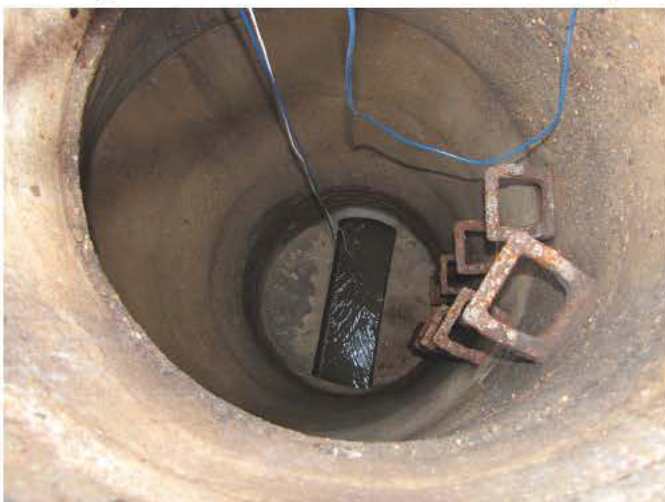
Abbildung 1: Pegelstands- und Temperaturmessung im Schachtbauwerk
