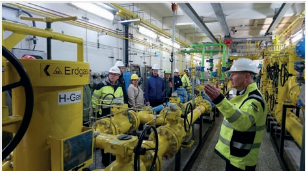
Bild 4: Herr Zielonka, Betriebsleiter der Stadtwerke Bielefeld, erläutert die Erdgaskonditionierungsanlage
