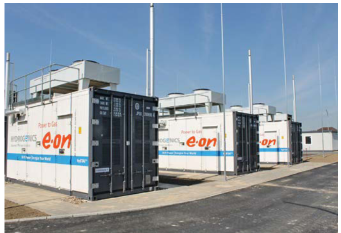
Pilotanlage zur Wasserstoffherzeugung: Im August 2013 nahm E.ON die „Power to Gas“-Pilotanlage im brandenburgischen Falkenhagen in Betrieb. Foto: E.ON
