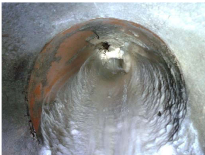
Bild 1: Sinterausbildung im Pörzbergtunnel (IAB Weimar GmbH)
