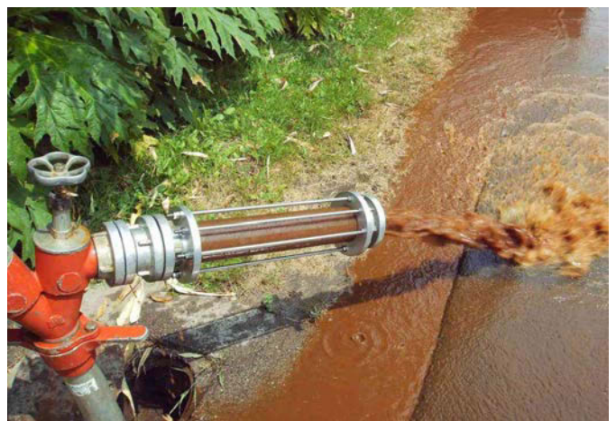
Das Reinigen von Trinkwasserrohrleitungen dient dem hygienisch einwandfreien und sicheren Betrieb. Dies ist gerade im Zusammenhang mit rückläufigen Wasserabnahmen und Stagnationen im Leitungssystem, z.B. durch den demografischen Wandel, von großer Wichtigkeit. Foto: Hammann GmbH
