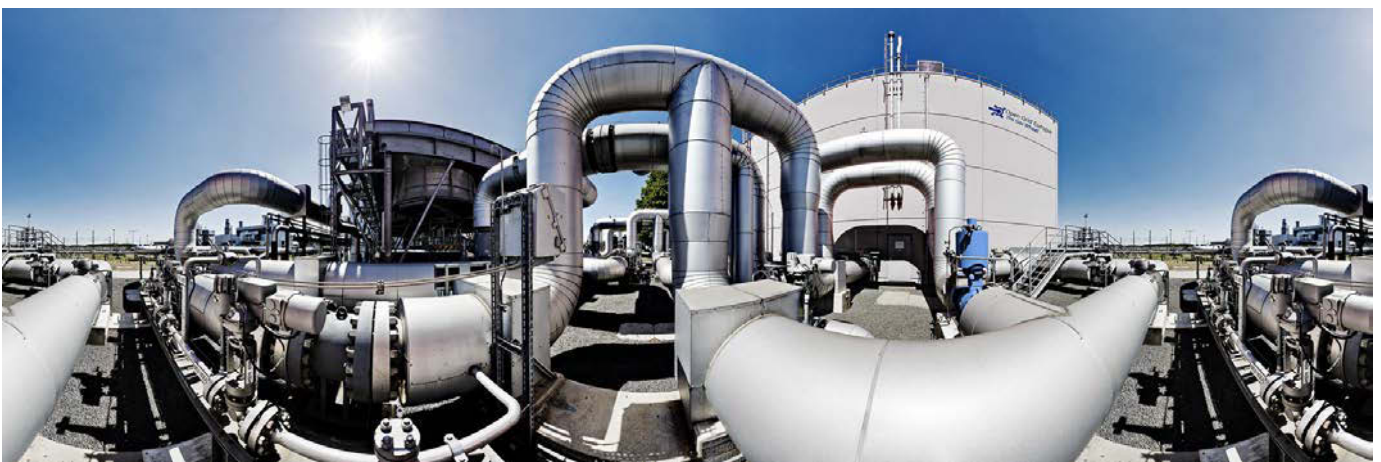
Verdichterstationen sind ein wesentliches Element einer Gas-Transportkette – vom Speicher über die Transportleitungen ins Verteilnetz. Hier: Verdichterstation Porz, Open Grid Europe GmbH Foto: Open Grid Europe GmbH
