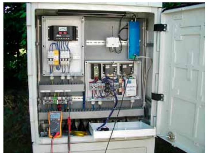
Schutzanlage mit KKS – Fernüberwachung Fotos: Harzwasserwerke
