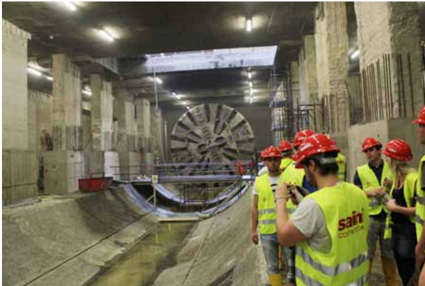
Blick auf das Schneidrad der Tunnelbohrmaschine in der Haltestelle „Jonio“ der „Metro of Rome“
