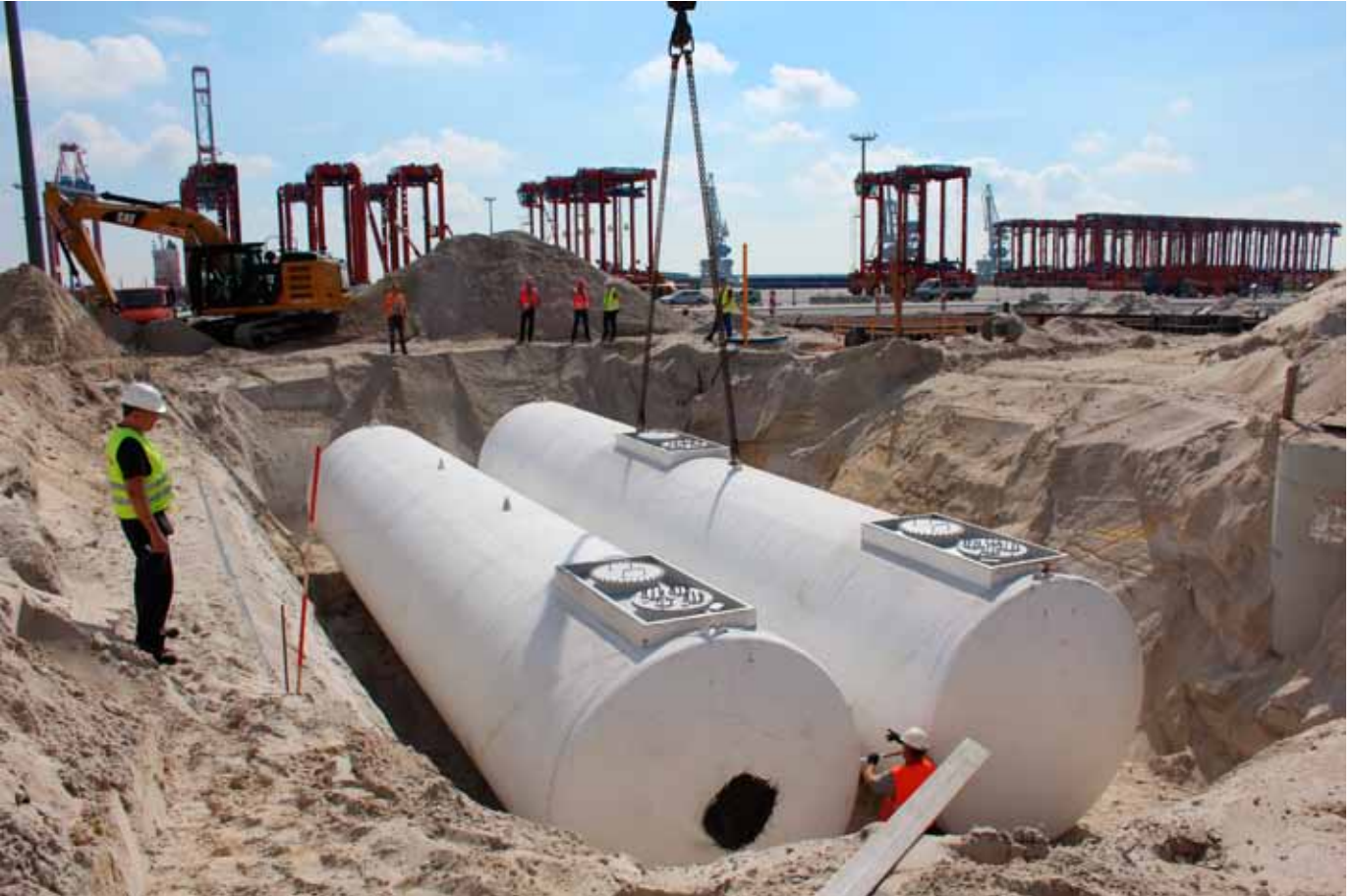
Die Tanks haben ein Volumen von 100 cbm und wurden in Wilhelmshaven beim Weser-Jade-Port eingelagert
