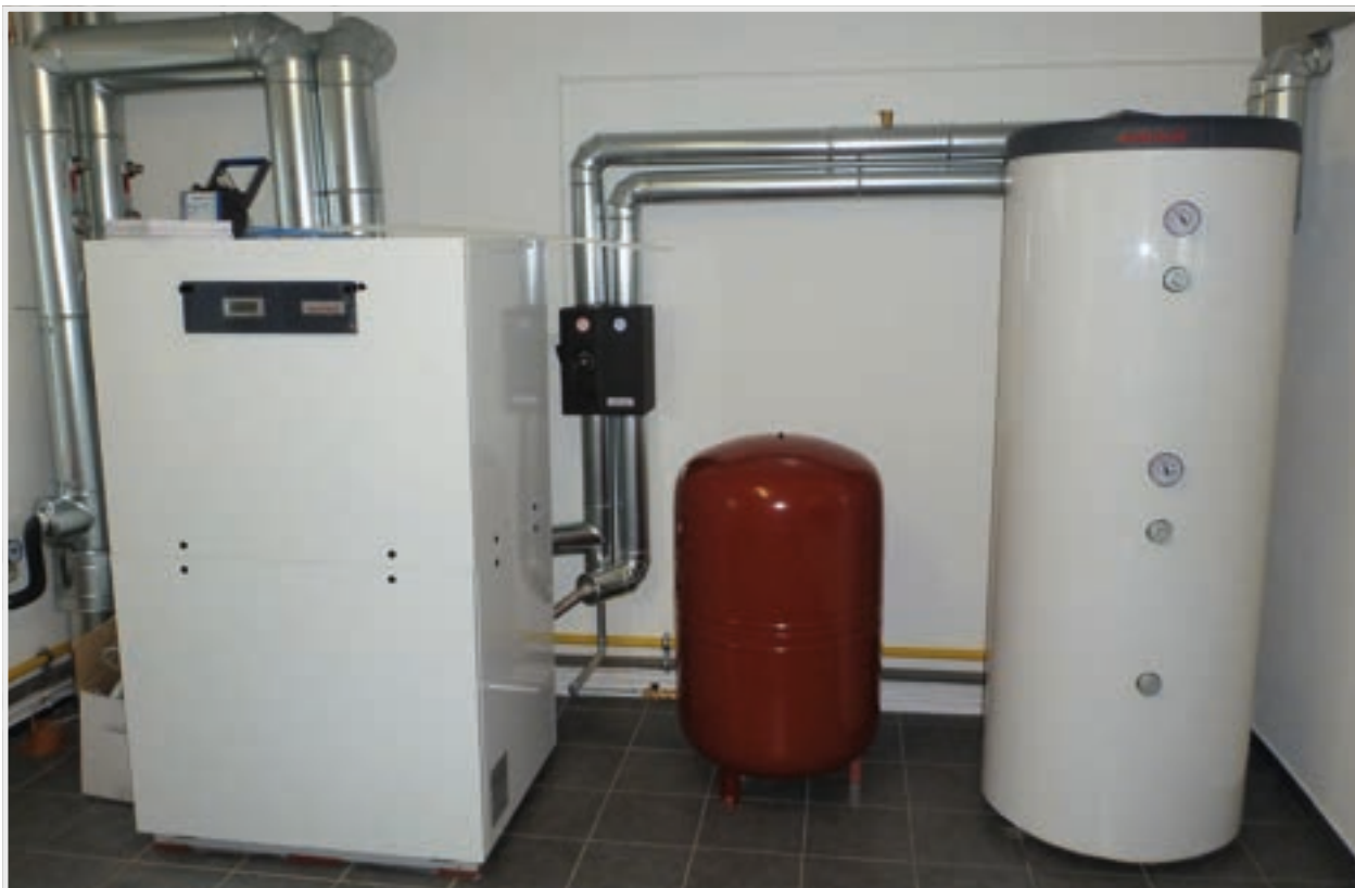
Abbildung 1: iro - Heizungsanlage (Wärmepumpe und Pufferspeicher)
