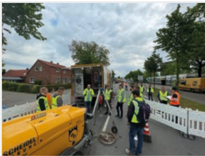
Besichtigung einer Linerbaustelle in Delmenhorst, Mitarbeiter der Firma Diring & Scheidel erklären den Studierenden die Technik
