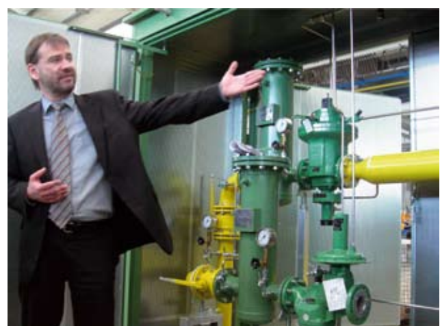
Herr Dipl.-Ing. Völler erläutert die Funktion eine Gas-Druckregel- und Messanlage
