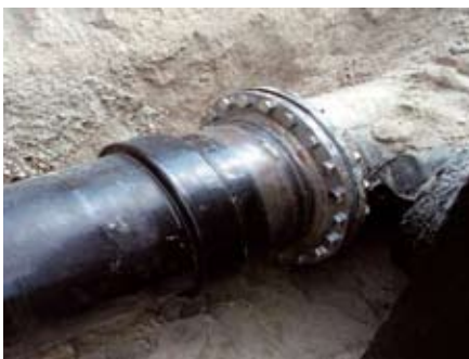
Isoliertrennstück im Erdreich
