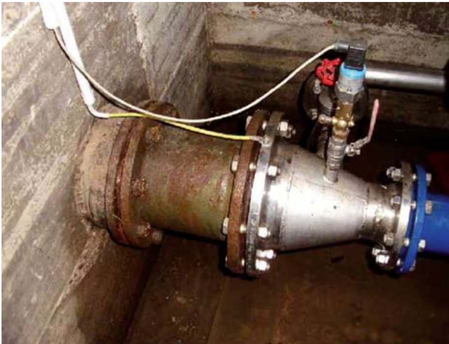
ÜS Schacht mit Messdatenübertragung – Anschlussleitung extrem gefährdet
