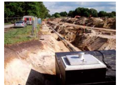
Übergabeschacht mit Isoliertrennflansch und zusätzlicher Rohrstrommessung
