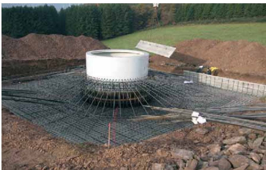
Abbildung 1: Fundament für eine Windenergieanlage
