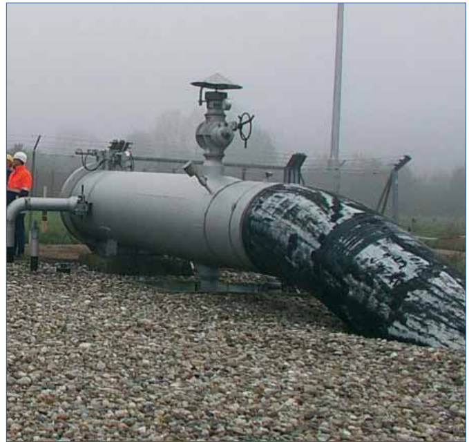
Molchschleuse der Gasverdichterstation der E.ON Ruhrgas
